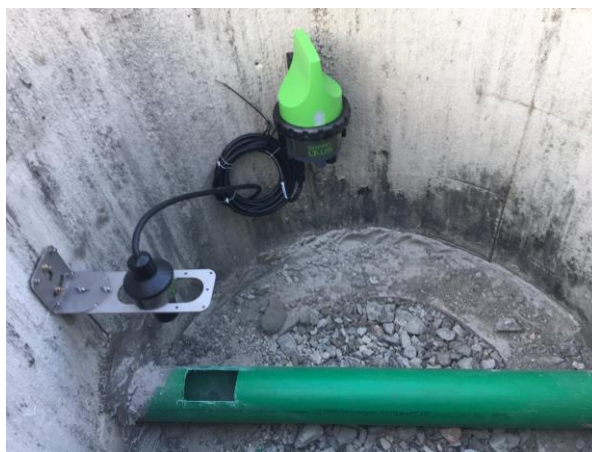
Рисунок 3 - Пример монтажа АП в колодце
